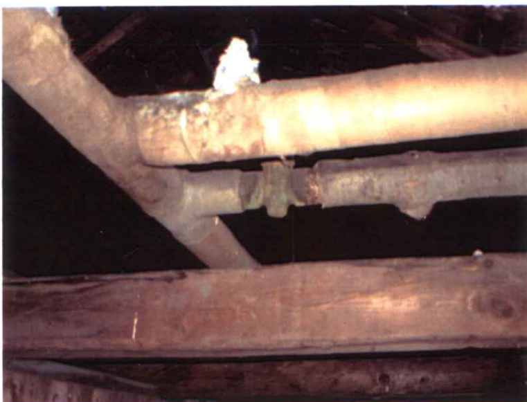
Foto nr. 15 udfældning og irret varmeledninger på loft.
