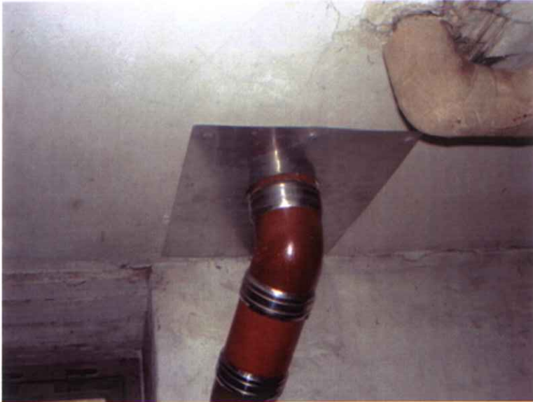
Foto nr. 13 stålplade løsning omkring udskiftet faldstamme. Denne løsning er ikke brandsikker.
