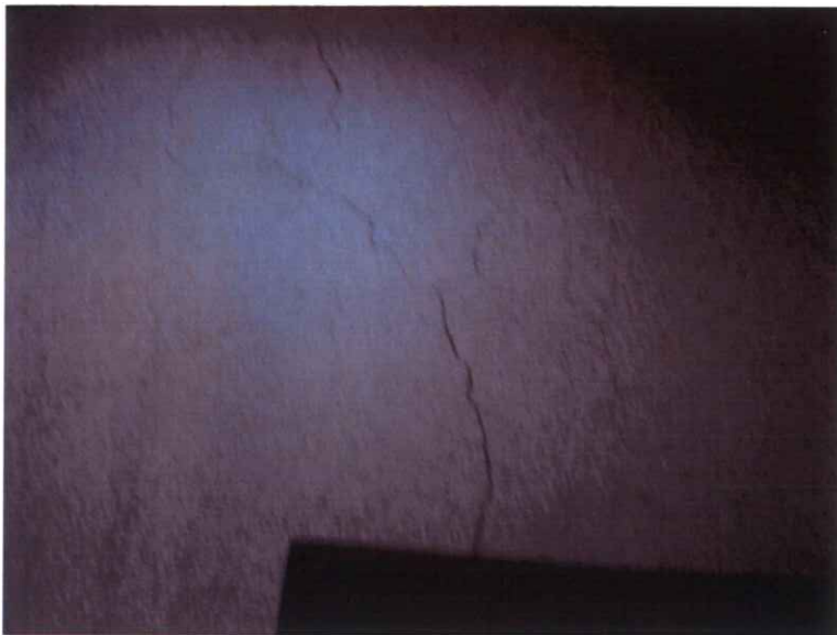
Billede 35 Revne i terrazzo ved k ældergennemgang.
