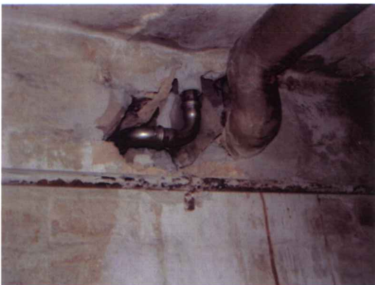
Foto nr. 3 manglende brandsikring efter renovering/omlægning af brugsvand.
