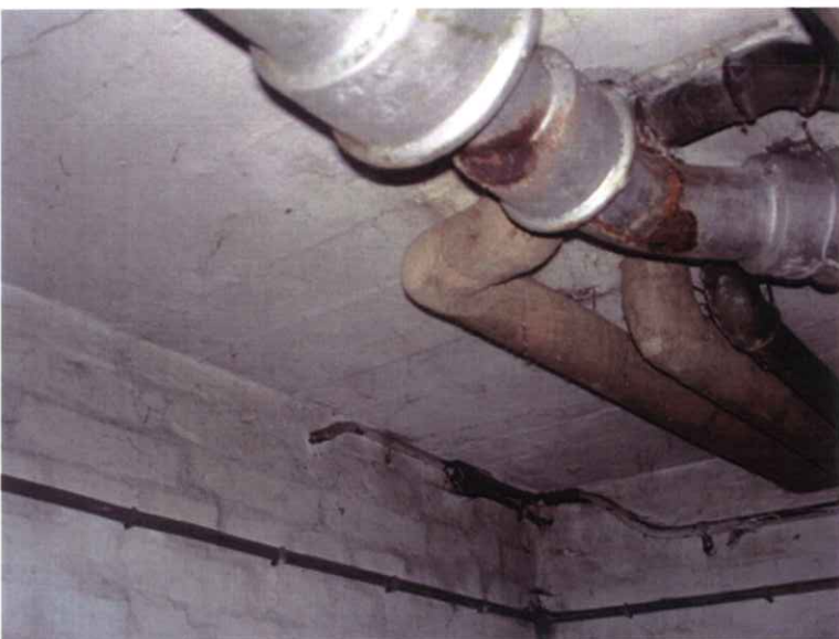
billede 21 Tæret afløbsrør i kælder
