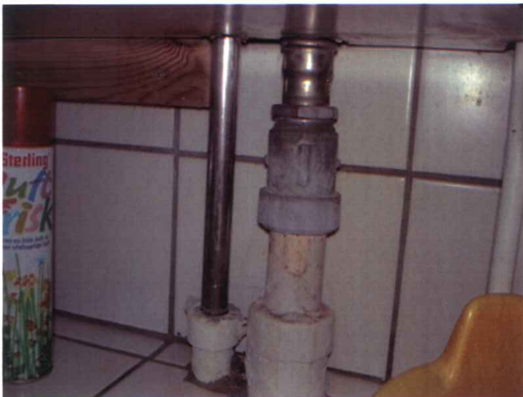
Foto nr. 9 udskiftning af brugsvandsrør i lejlighed. Udskiftningen er udført i andet materiale.
