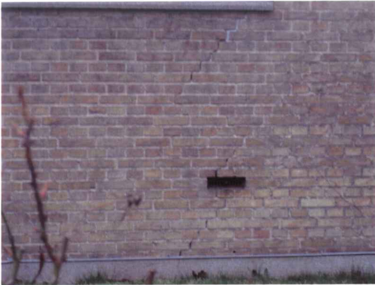
Billede 28 Revne i facade.
