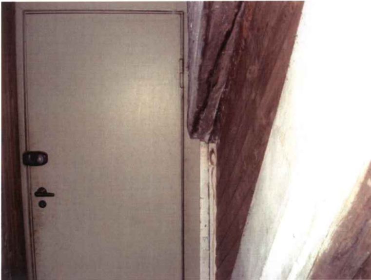
Billede 29 Opfugtning under skotrende.
