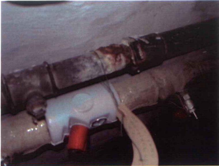
Foto nr. 4 rustdannelse på brugsvandsrør.
