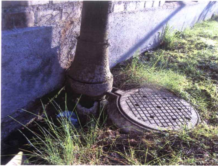
Billede 34 Defekt tagnedløbsbrønd ved Ewaldsensvej.
