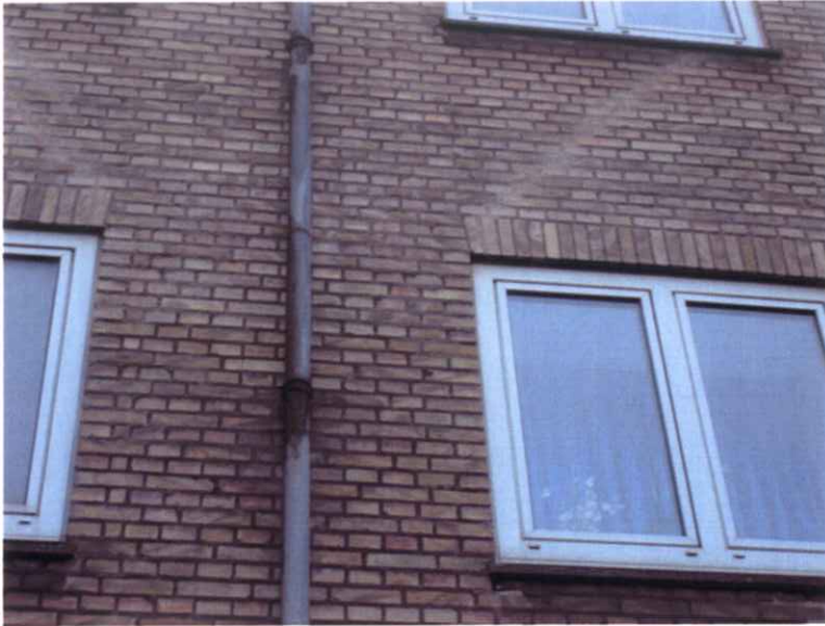
Billede 25 Utætte nedløbsrør og opfugtet facade
