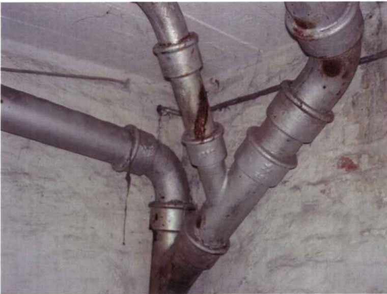
Billede 20 Tærede nedløbsrør i kælder
