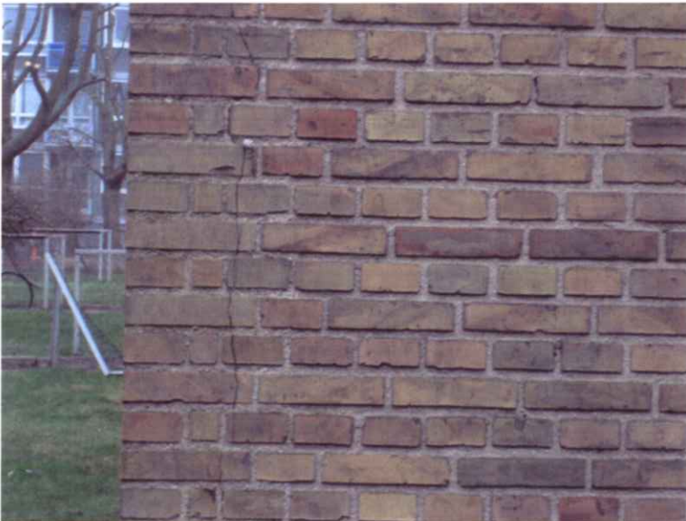
Billede 32 Revne ved udvendigt hjørne.
