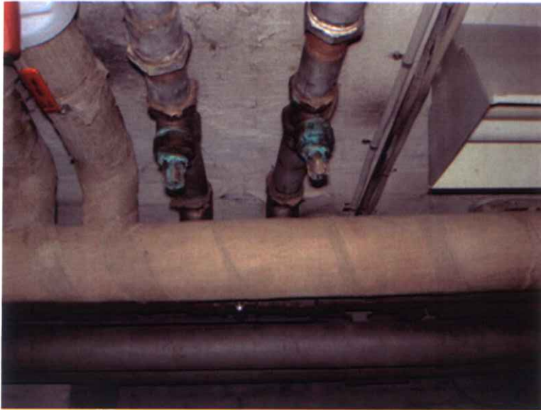
Foto nr. 11 greb på afspærringsventiler.
