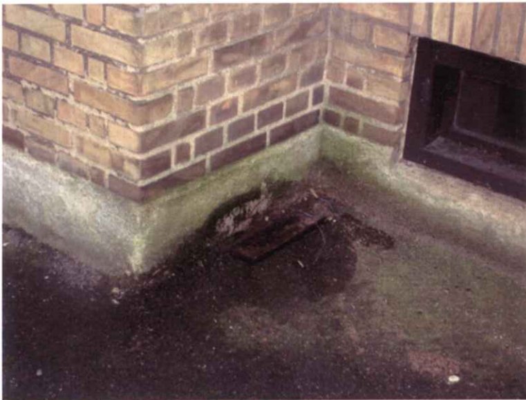
Billede 26 Opfugtning fra utæt tagnedløb.
