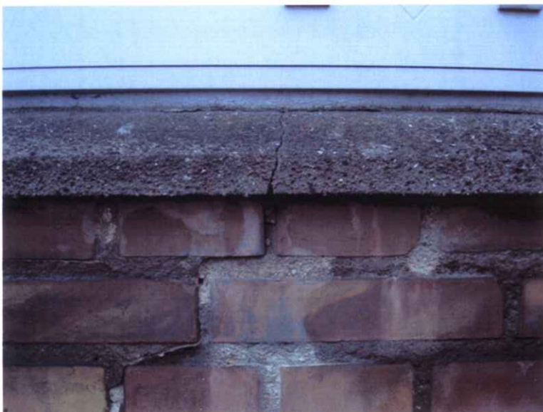
Billede 27 Revne i vinduesbrystning
